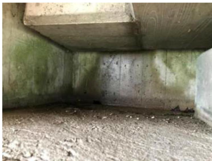
Durchfeuchtungen im Auflagerbereich am Widerlager
