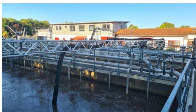
Abb. 4: Das Foto zeigt die eingehängten Rücklaufschlammumpen in Belebungsbecken 3, dahinter sind die Becken 2 und 1 mit eingehängten Pumpen für den Rücklaufschlammkreislauf zu erkennen.
